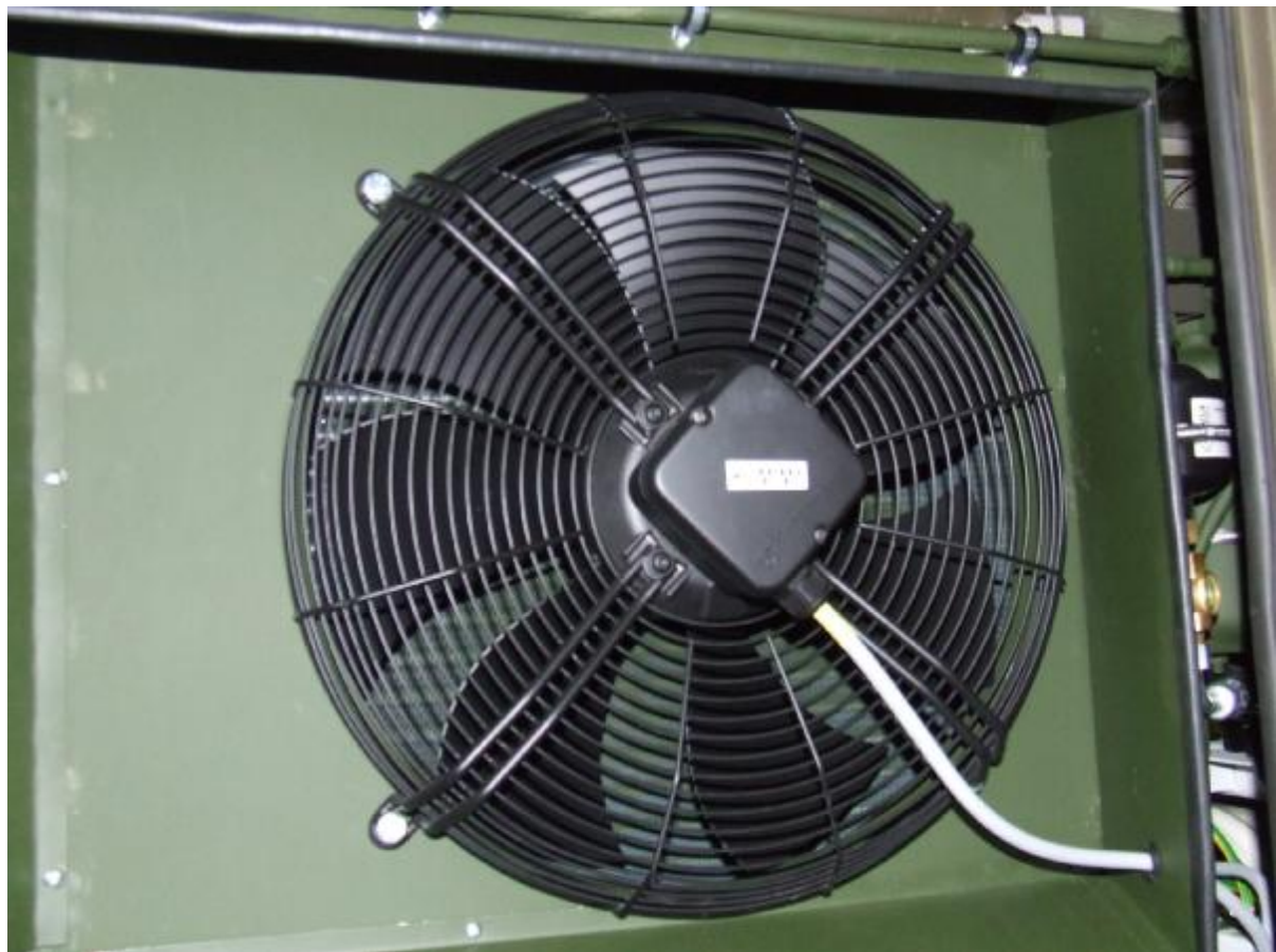
Rys. 3a Widok skraplacza – wentylator
